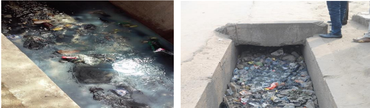
Photo 3: Les caniveaux servant de lieux de déversements des eaux usées ménagères
