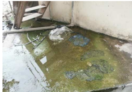
Fuite réparée par un caoutchouc Centre de Formation Maritime (CFM)
