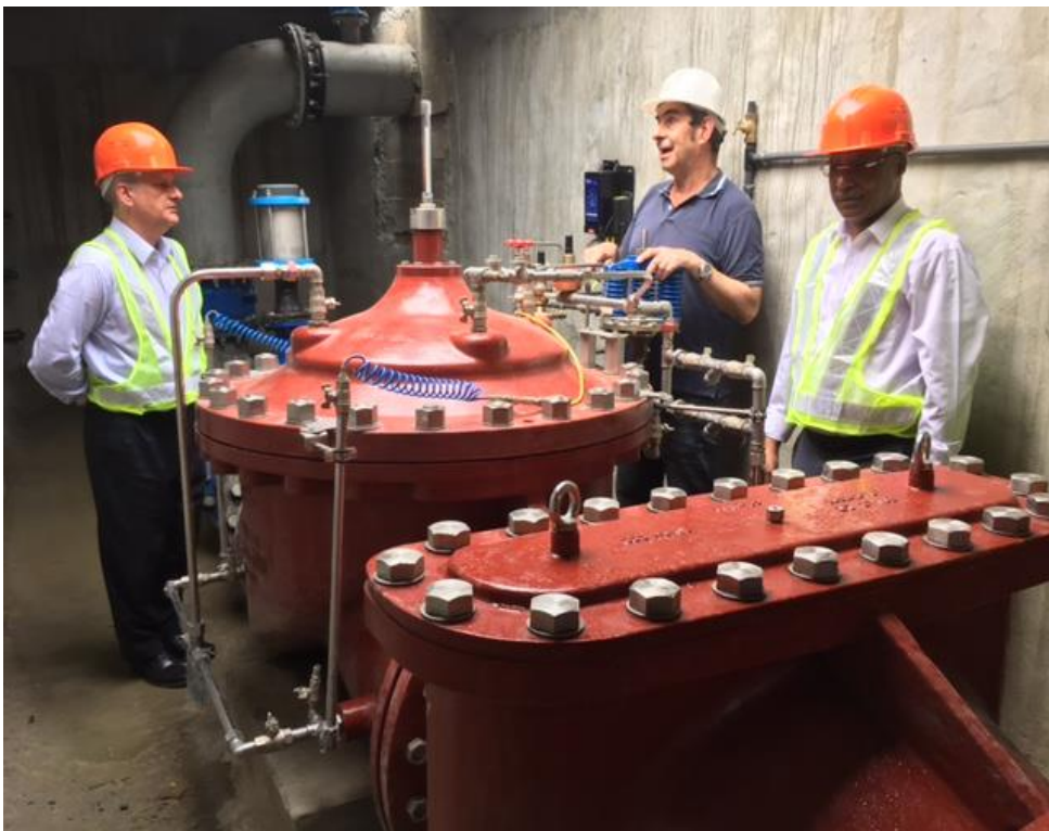
Figure 14 : Stabilisateur de pression DN 600 installé au pied du réservoir de Koumassi.
