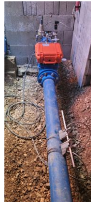
Dans une chambre existante – regard pour stabilisateur
