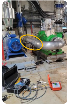
Contrôle débit de pompe sur conduite acier inox DN300 (après coude 90° , 6 trajets soniques). Qv = 550m3/h.
