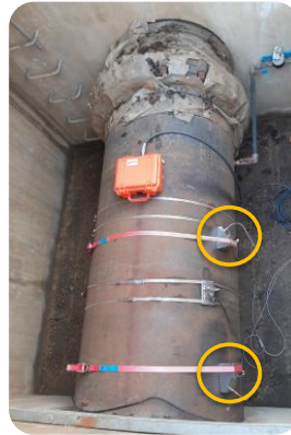
Contrôle sortie usine production sur conduite fonte ductile DN900 (2 TS, capteurs 0,5MHz).
