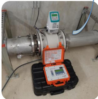
Comparaison DEM sur conduite en acier inox DN400.
