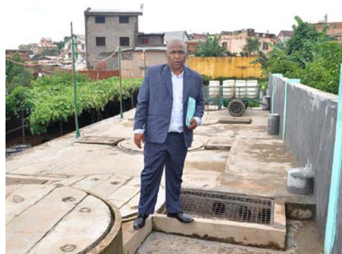
Station de traitement par réacteurs anaérobies à biogaz à Madagascar.
