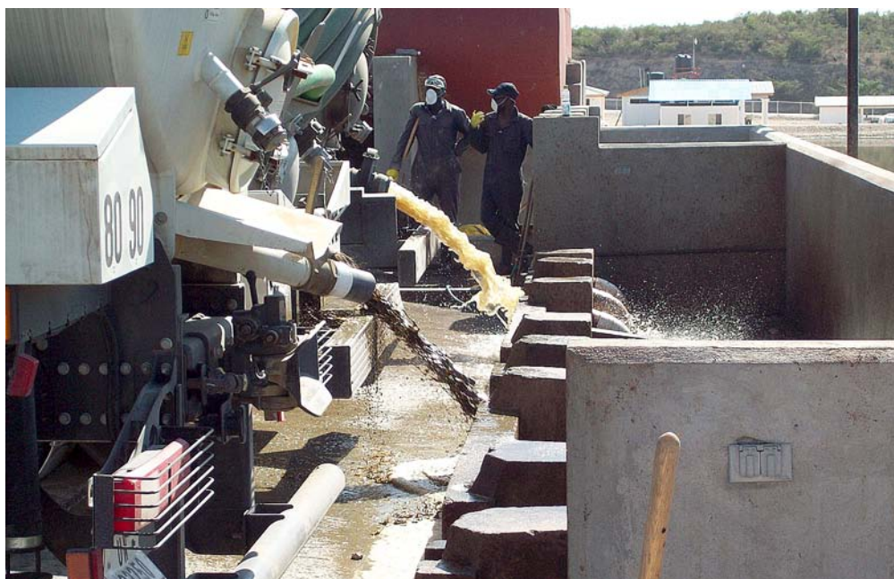
Dépotage des boues par des camions de vidange dans la station de traitement de Port-au-Prince (Haïti).
