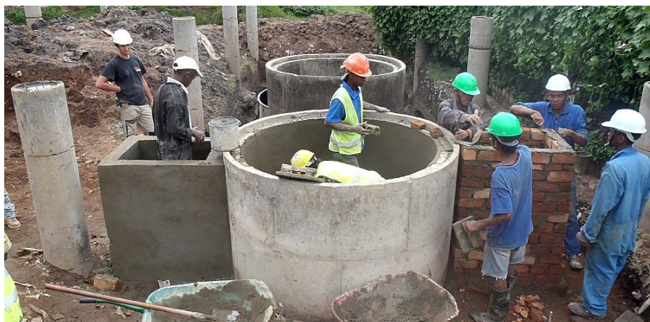
Construction de la station de traitement par biodigesteurs et filtre biologique à Tanjombato (Madagascar).
