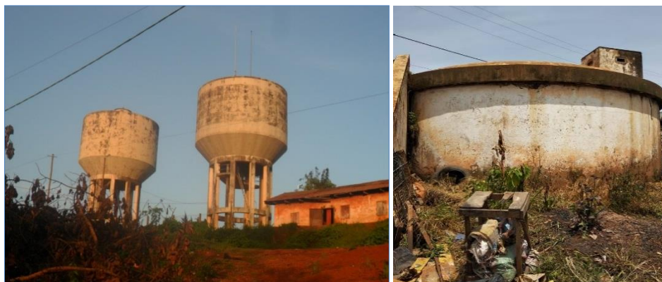
Fig. 6. Réservoirs de Banengo et Tamdja
